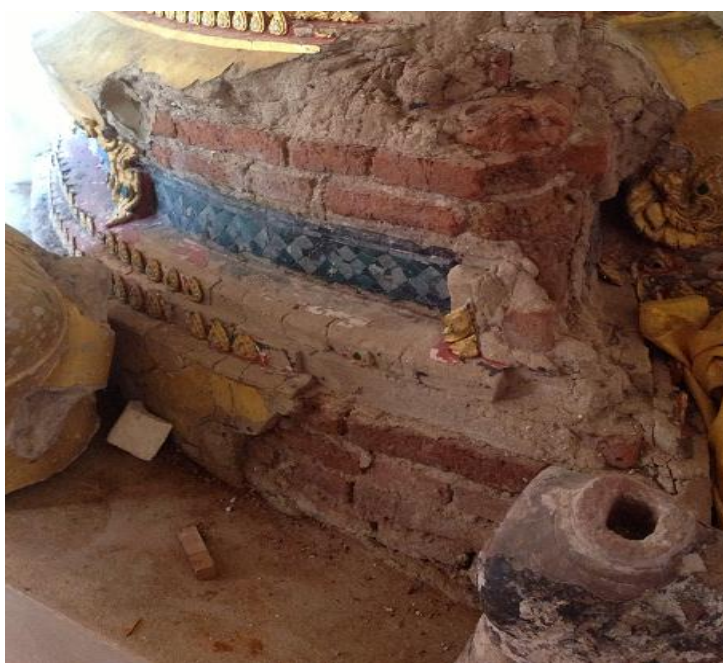
รูปที่ 2.22 บริเวณฐานพระประธานเกิดความชำรุด ทลุคเอียง ที่มา: บันทึกภาพถ่ายเมื่อ 9 มิถุนายน 2556
